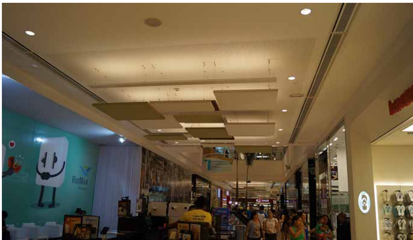
Sistema de vigas frias ativas no Shopping RioMar Kennedy, em Fortaleza
