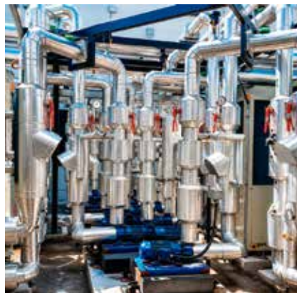
CAG: chillers modulares
